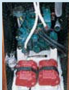
Im Schwerpunkt: Maschine und Batterien sind unter dem Niedergang konzentriert
